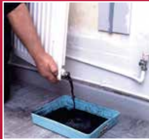
So sieht das „Blutbild“ einer Heizung aus, die behandelt werden muss.
